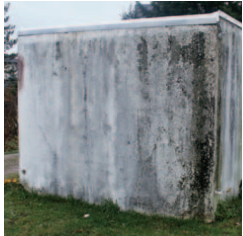
Westseite einer Garage: sehr feucht, wenig Sonne, kein Dachüberstand
