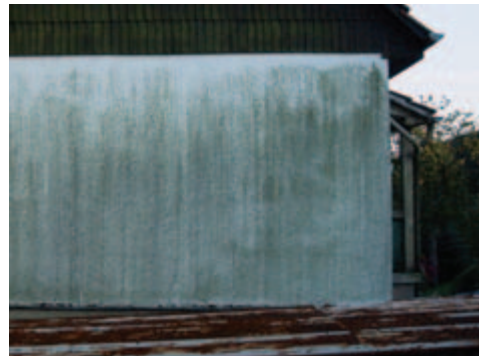
Typische, von Pilzen und Algen befallene Nordfassade
